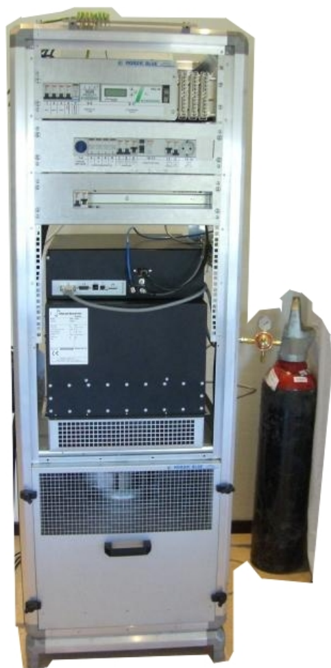
Coolrack mit Brennstoffzellen und Wasserstoff
