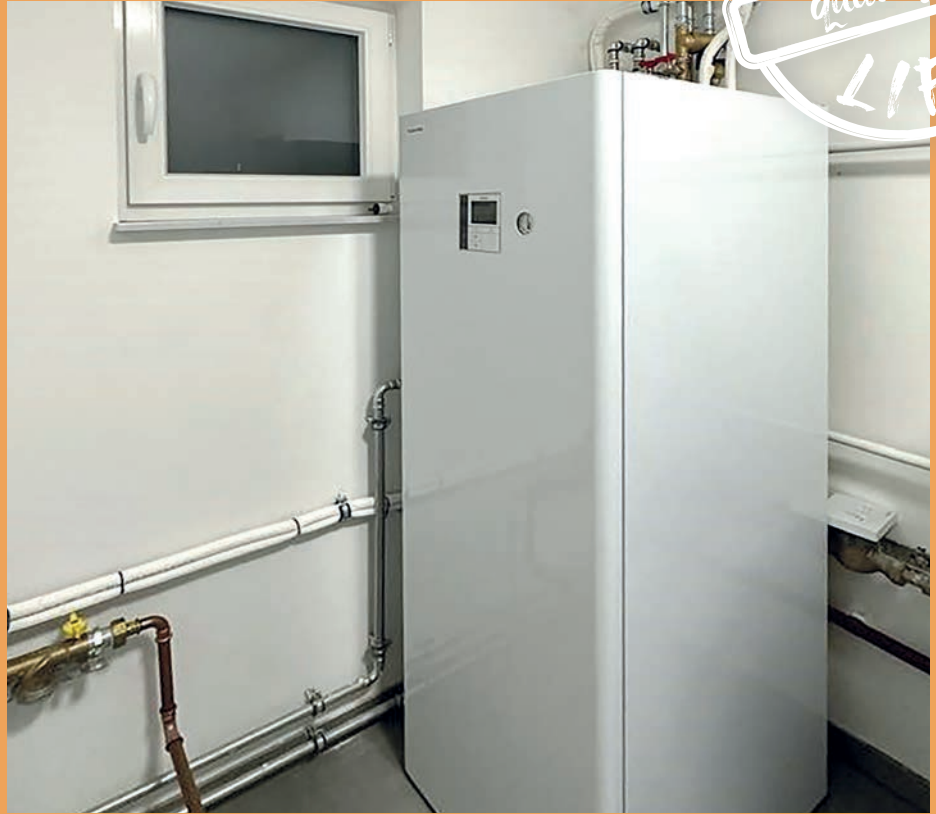
Einfamilienhaus, Manfred Schmelzer GmbH Kälte-Klima Service
