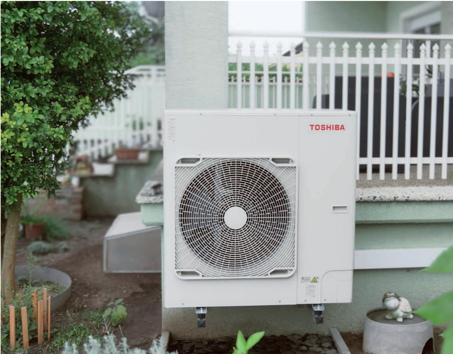
Einfamilienhaus Podersdorf, Robert Müllner GmbH - Kälte Klima Installateur
